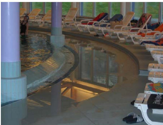
Abbildung 15 Kein Gefälle vorhanden, Wasserabfluss funktioniert nicht
